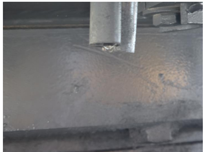
A/Cドレン状況写真
