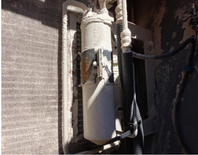
A/Cドライヤー状況写真①
