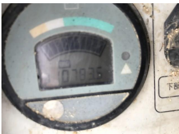
H R稼働状況
