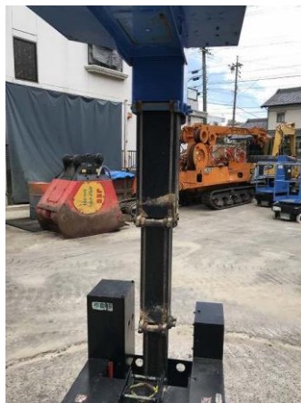
下部操作による機械作動確認
