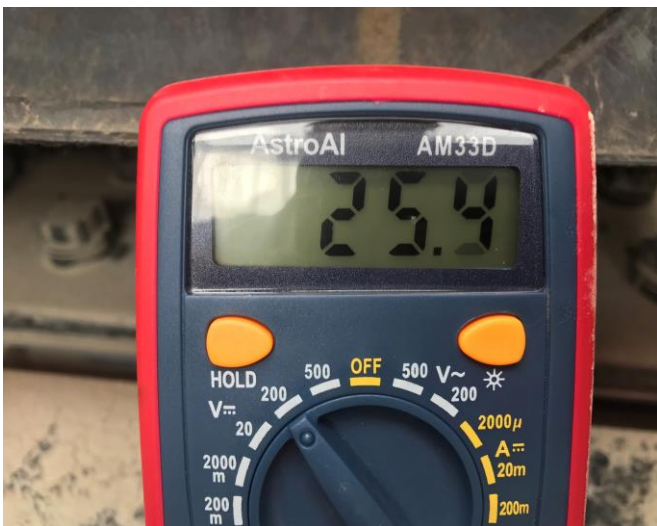
バッテリー電圧測定 (E/G始動前)
