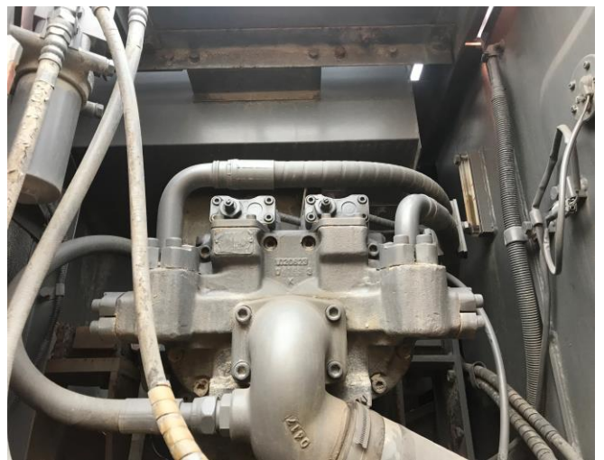
油圧ポンプ全体写真
