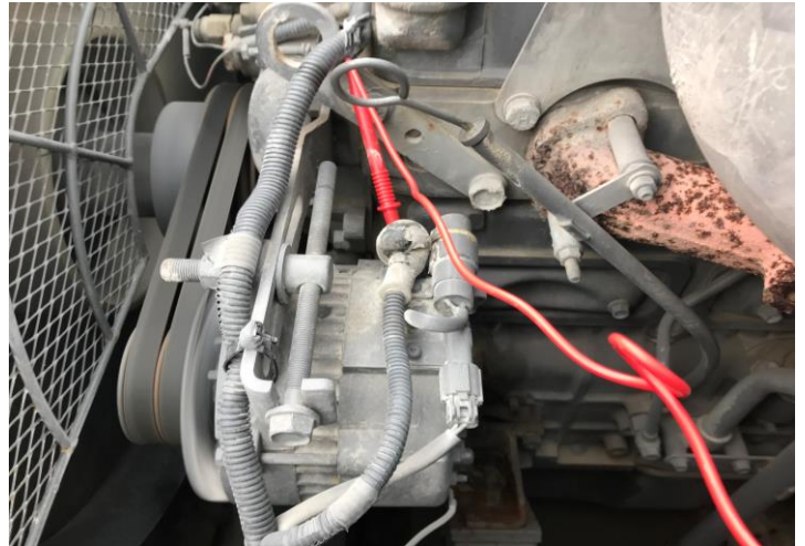
オルタネーター電圧測定状況写真
