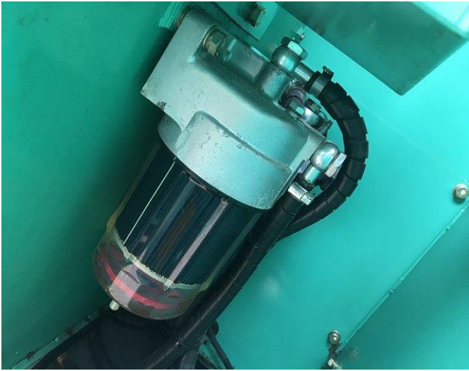
燃料エレメント交換
