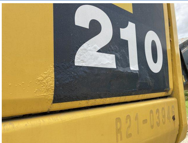
エンジンルームパネル錆び腐食
