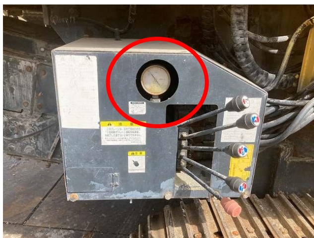
クレーン荷重計不良
