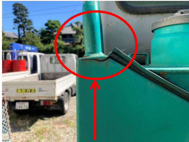
燃料タンクカバー亀裂
