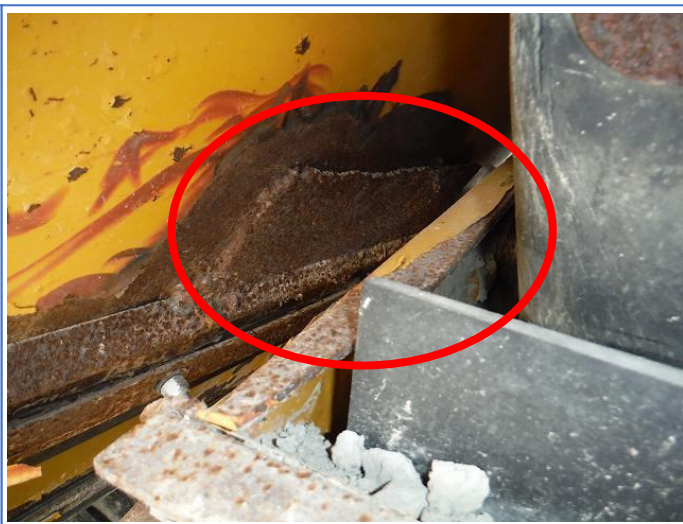
ズリ抜きシューター下部補修跡②
