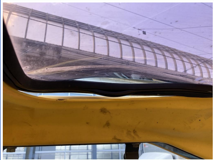
CNP天窓アクリル板破損 ②
