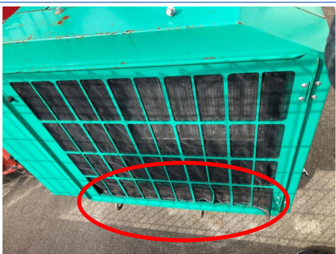
ラジエター前側メッシュ端破れ①
