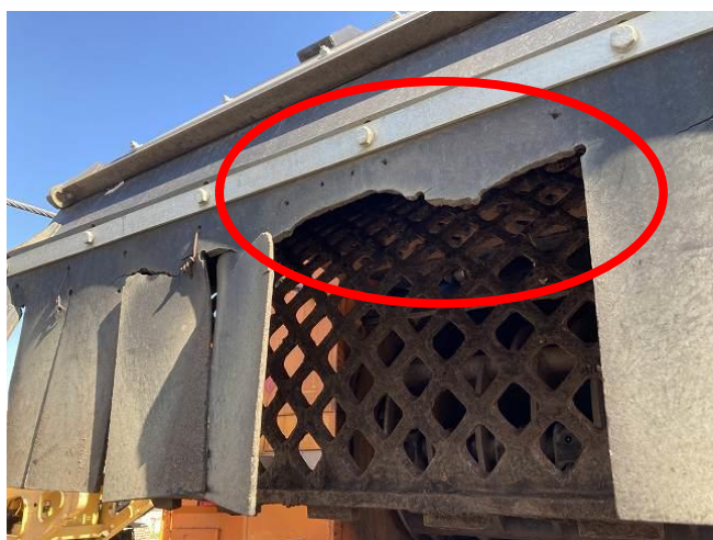
スクリーン昇降部ゴムカーテン破れ
