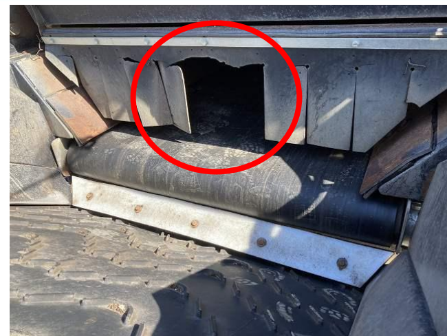
一次コンベヤ排出部ゴムカーテン破れ
