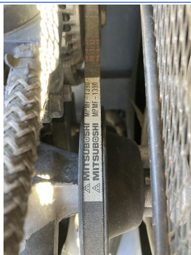
ファンベルト劣化
