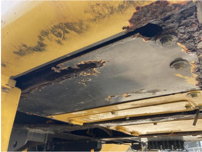
底板 錆腐蝕 穴あき ②
