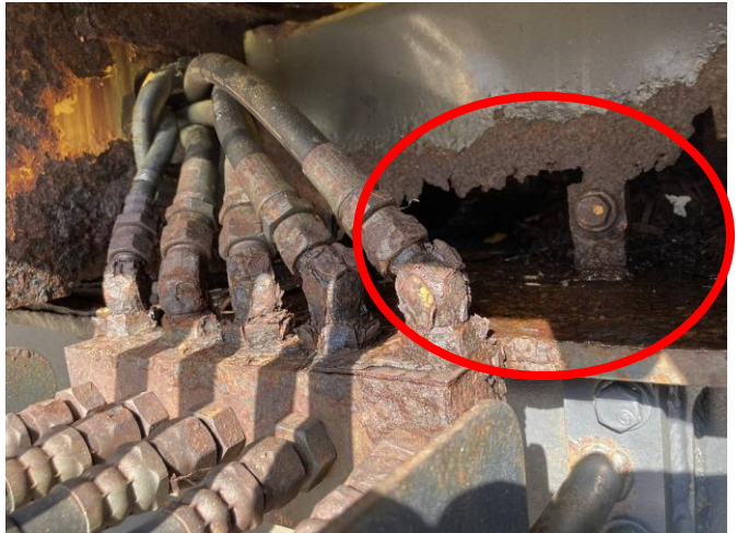
内部側面パネル錆腐蝕 穴あき
