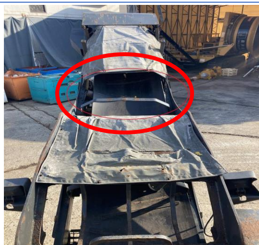
排出コンベア飛散防止シート一部欠品
