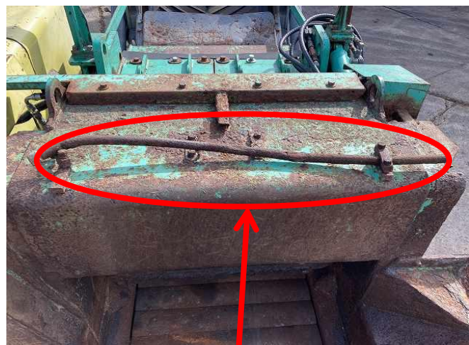
散水パイプ曲がり
