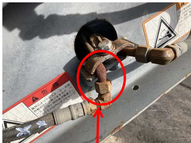
伸縮シリンダー油圧配管曲がり
