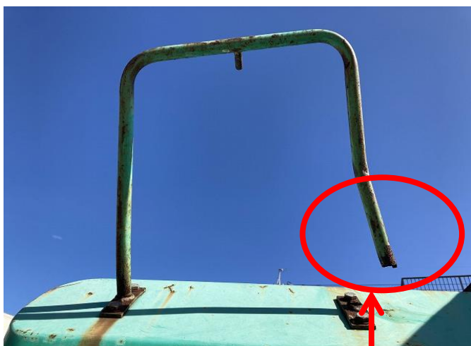
ミラー取付ステー破損
