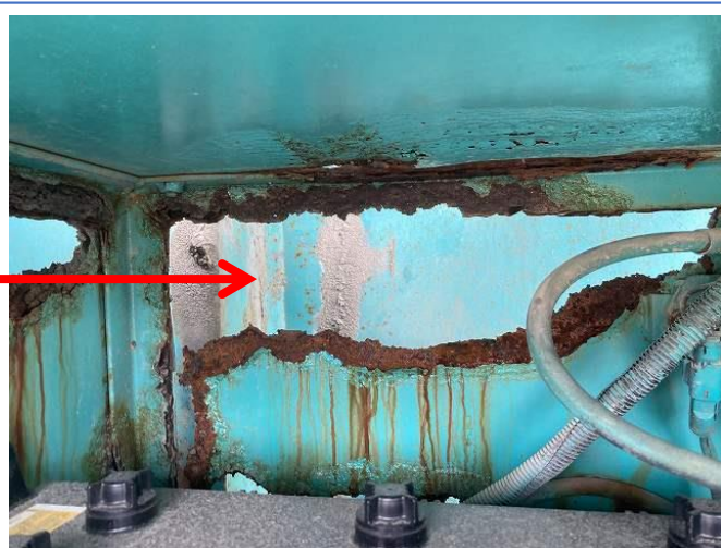
バッテリーケース腐食（拡大）
