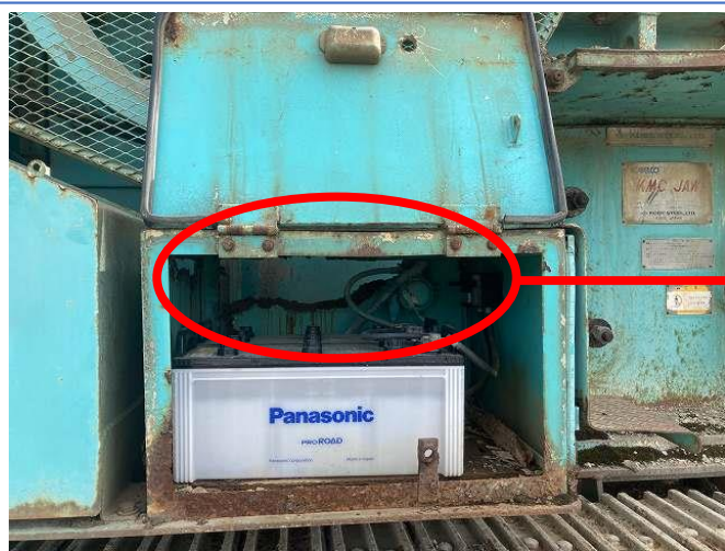
バッテリーケース腐食
