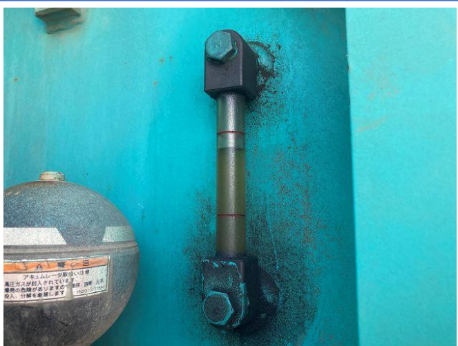
作動油タンクレベルゲージより漏れ
