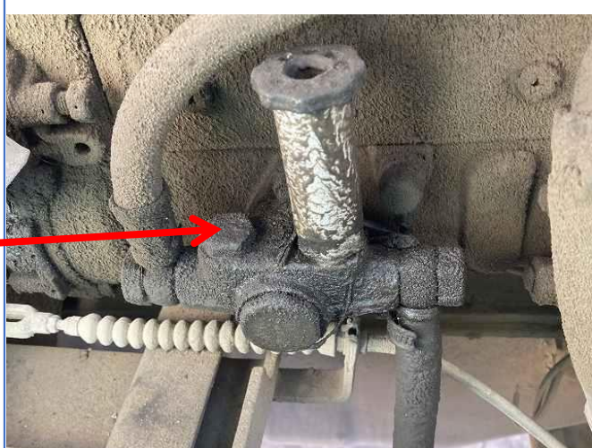
手押しポンプより漏れ（拡大）
