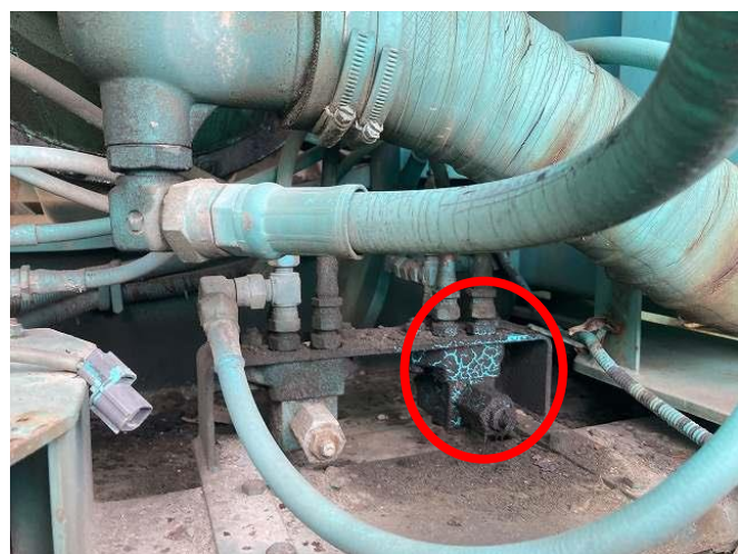
作動油バルブより漏れ
