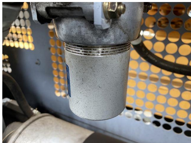
作動油エレメント油漏れ
