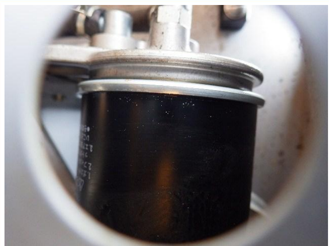
燃料エレメント交換
