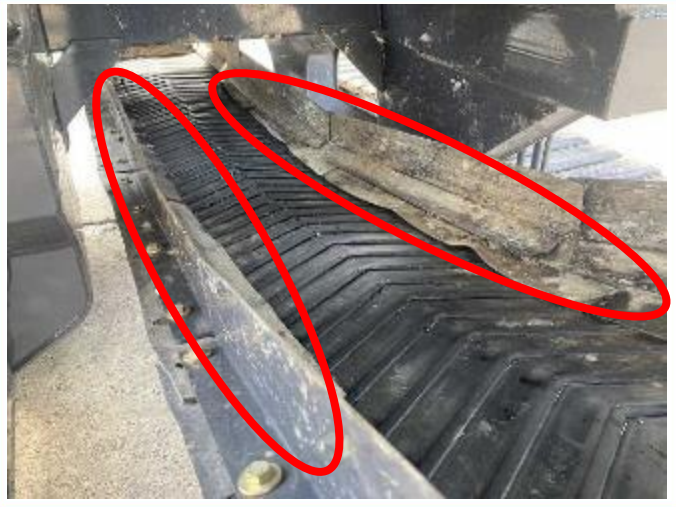
コンベアスカートゴム経年劣化
