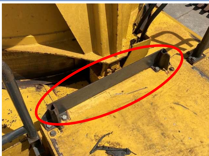
手すり柵 破断・欠損
