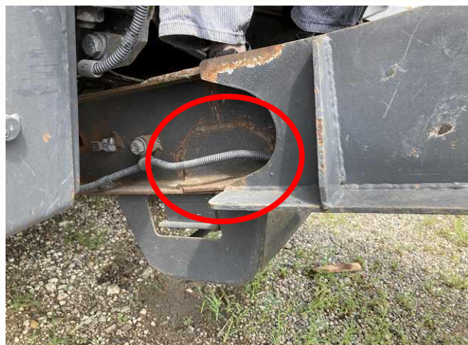
コンベアフレーム補強跡
