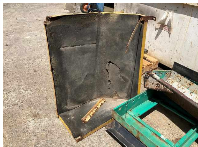
防音カバー変形・ステイ破損
