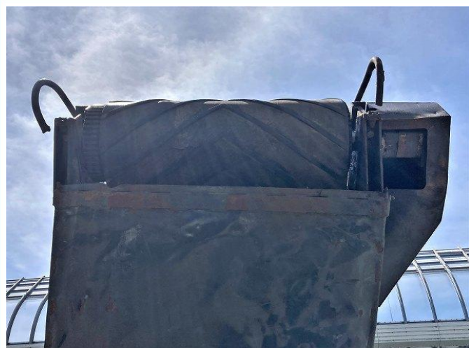
ヘッド側コンベアゴム偏り
