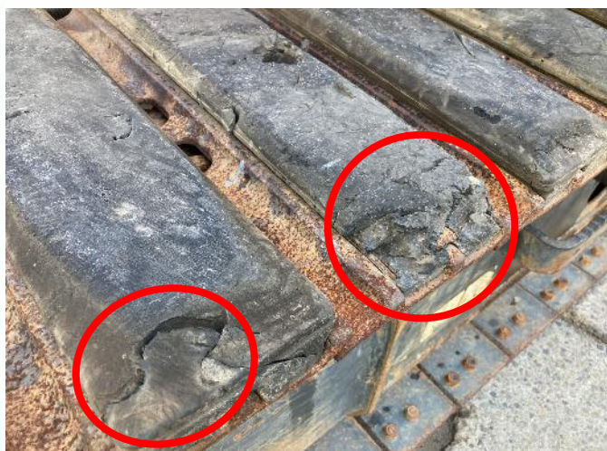
ゴムパッド亀裂
