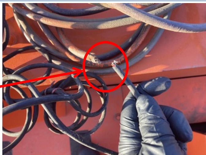
クレーンリモコンコード断線②
