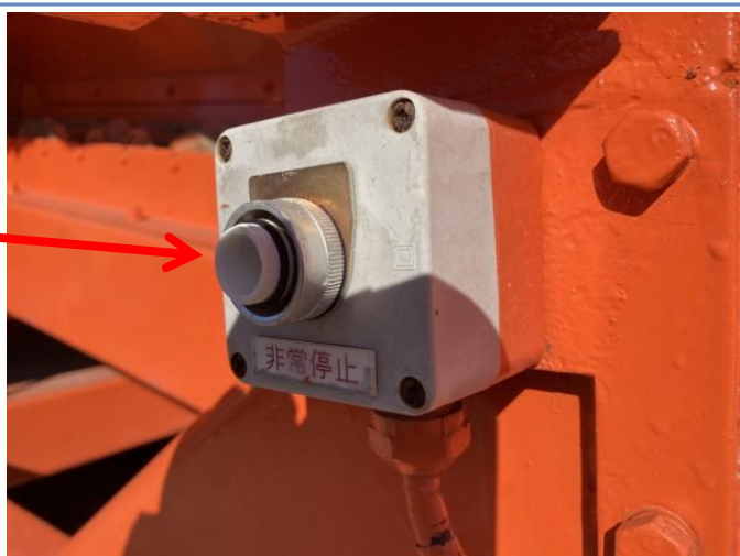
投入フィーダー下非常停止ボタン欠損②
