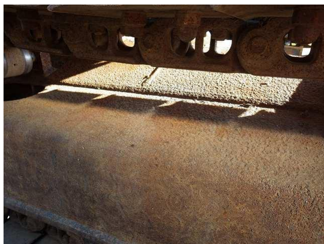
トラックフレーム左側錆び
