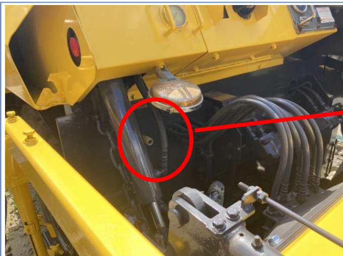
散油ノズル欠損①
