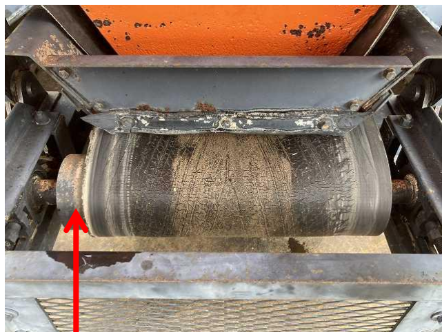
コンベアベルト後端片寄り
