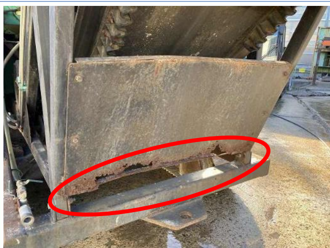
コンベア外装カバー下部腐食
