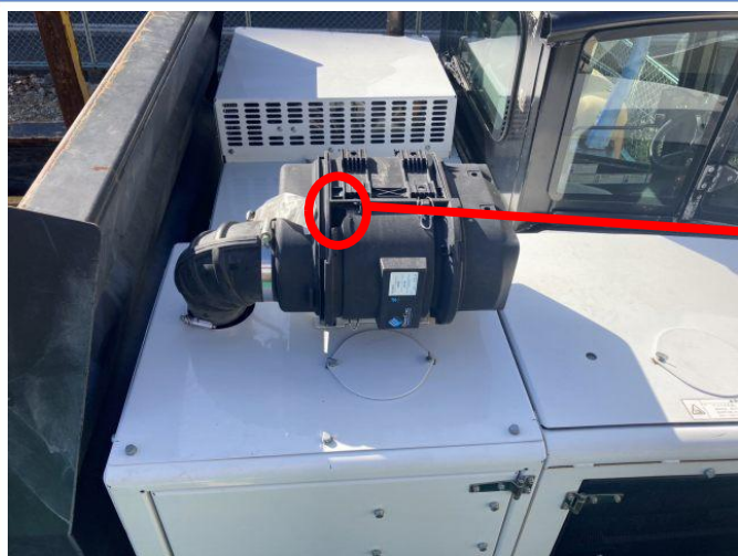
エアークリーナーケース破損①
