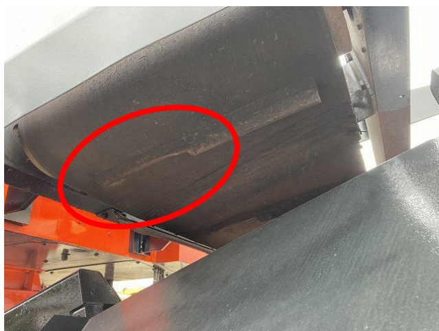
磁選機ベルト破損(一部)
