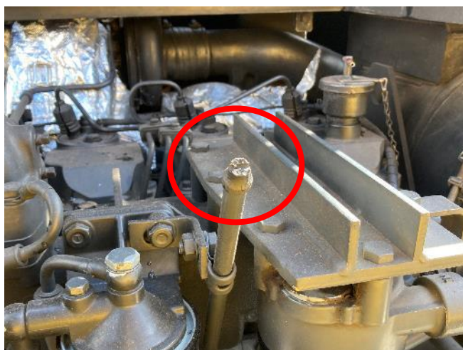
オイルレベルゲージつまみ折損
