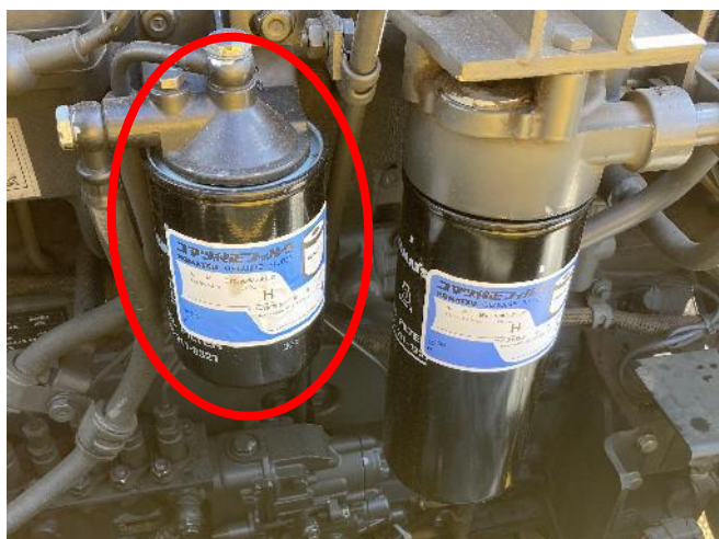
燃料エレメント交換
