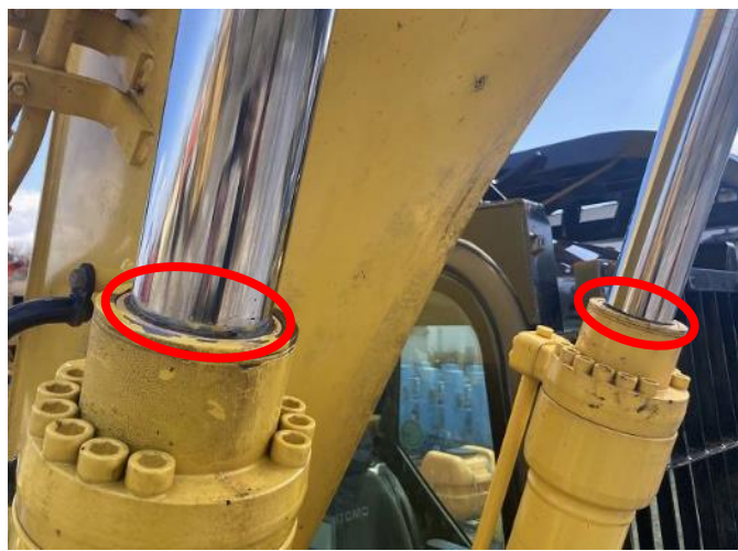
ブームシリンダーダストシール劣化
