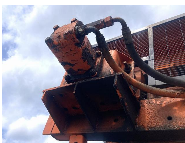
排出コンベアモーター油にじみ
