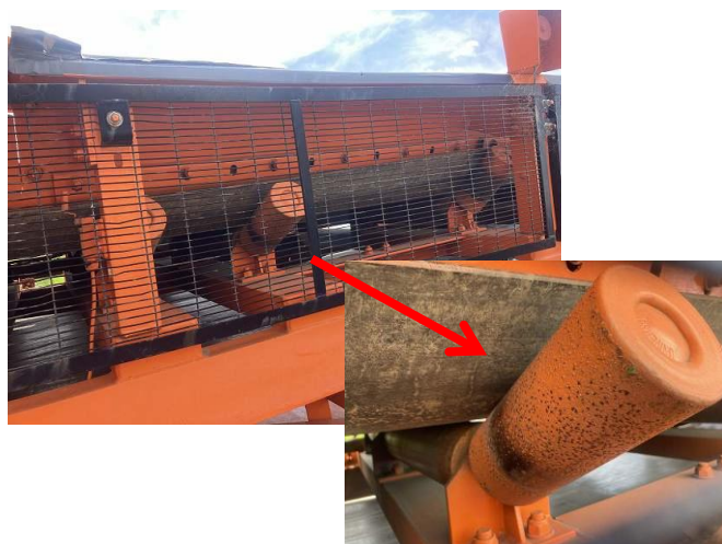
コンベアローラー固着箇所あり
