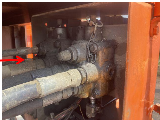
操作レバー油にじみ②(裏側)
