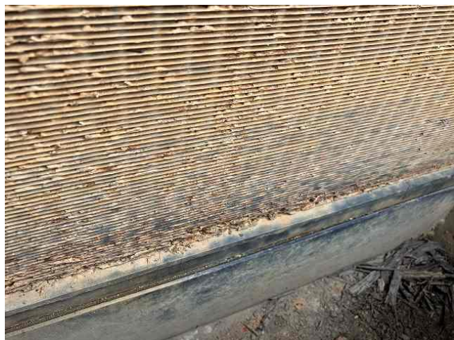
ラジエーターコア下部 サビ、腐食
