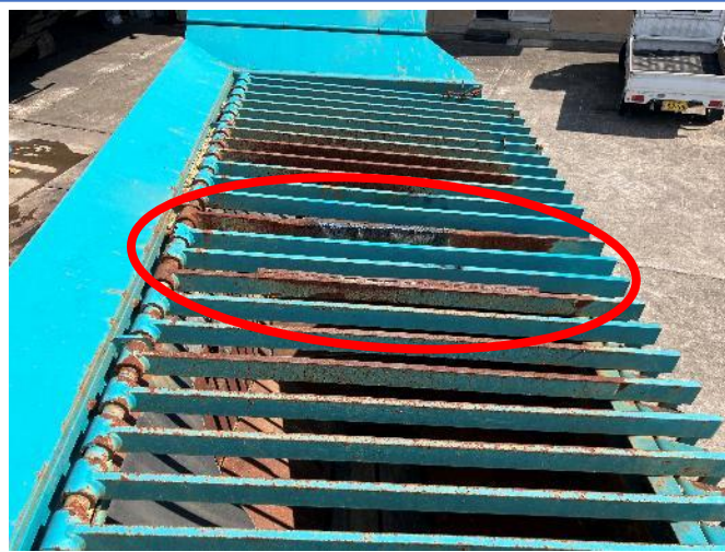
グリッドバー 補強跡あり
