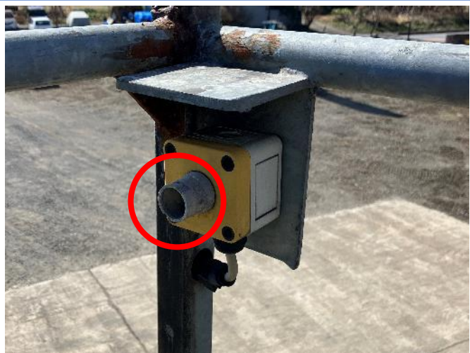
非常停止ボタン破損
