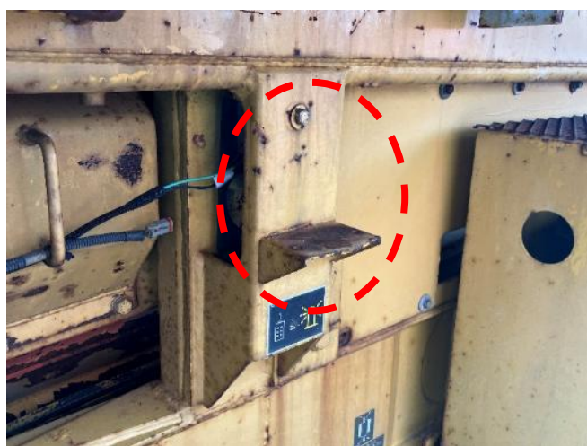
ビーコンランプ(本体裏側) 欠損
