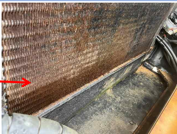
オイルクーラー下部錆浮き②
