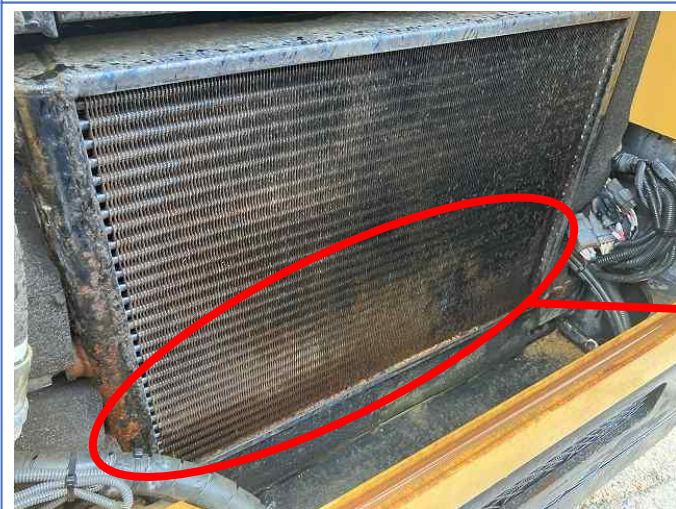
オイルクーラー下部錆浮き①
